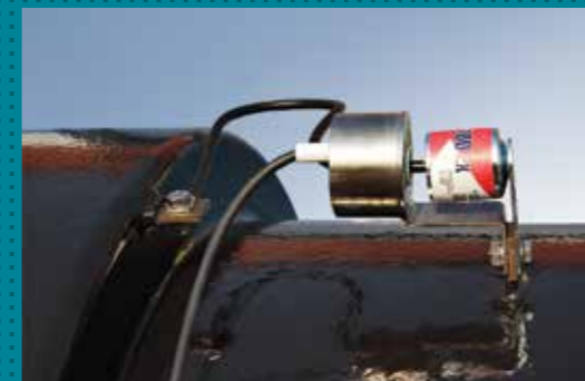
Датчик МКИ на искроразряднике
