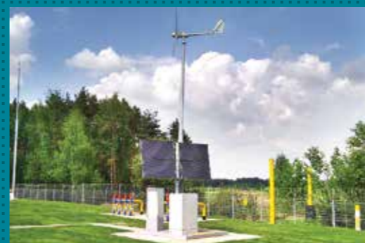
ПЭКЗ с питанием от солнечных батарей и ветрогенератора
